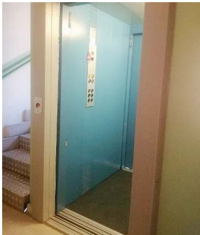
In servizio. L'ascensore è tornato a funzionare
